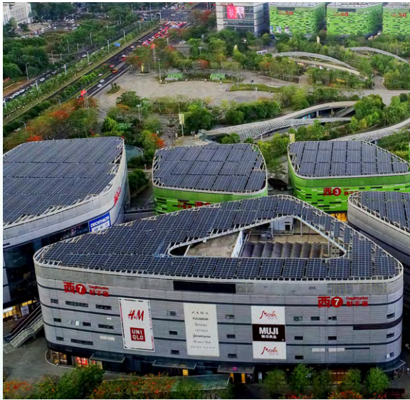
海口日月广场屋面光伏面板
